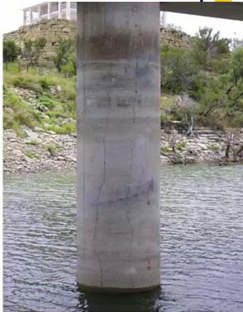
Fissuração em sentido preferencial provocada pela RAA em um pilar.
