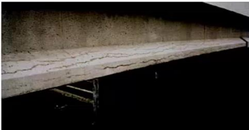
Fissuração provocada pela RAA: Viga pré-fabricada.
